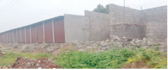
మామిళ్ల నాలా బఫర్ జోన్‌లో నిర్మిస్తున్న అక్రమ నిర్మాణం
